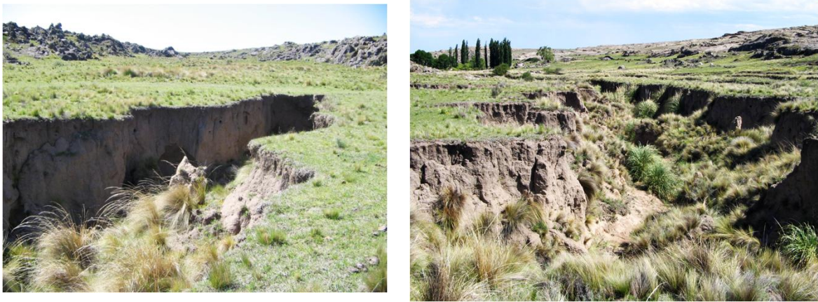
Figura 23 c. Erosión en cárcavas
