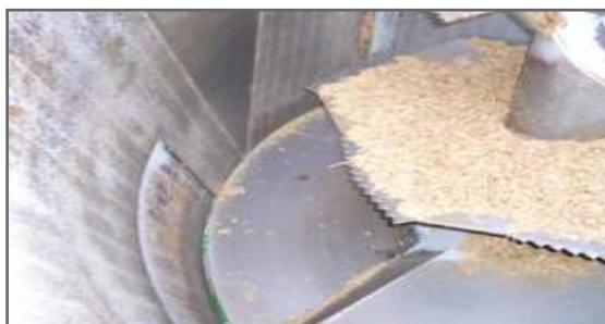
Figura 4.3. Se observa algún desgaste de la pintura interna
