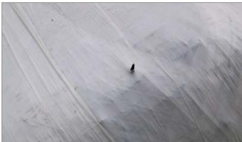
Figura 5.5. Se observa el perforado de la cobertura plástica, debido a un tallo.
