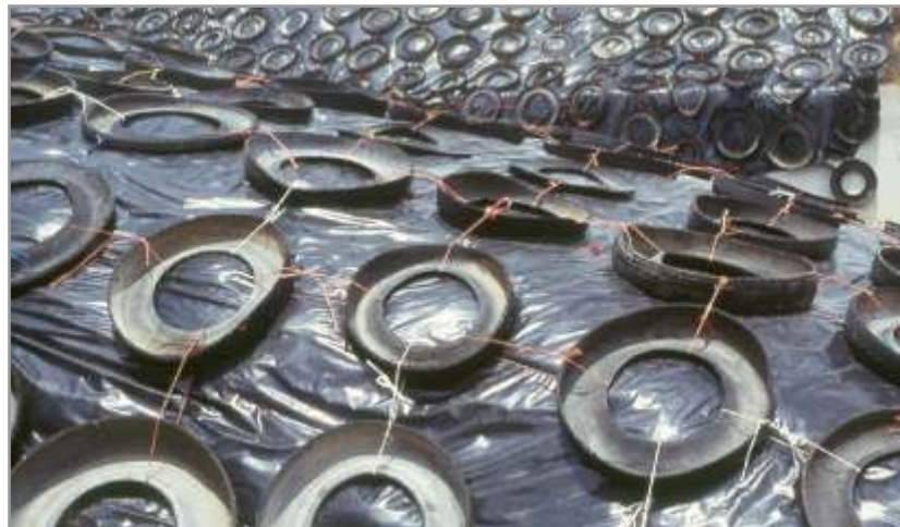
Figura 6.39. Cubiertas de auto cortadas al medio y debidamente colocadas y unidas entre sí.
