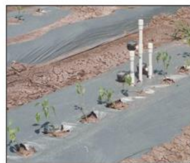
Estación de tres tensiómetros instalados a diferentes profundidades del suelo.
