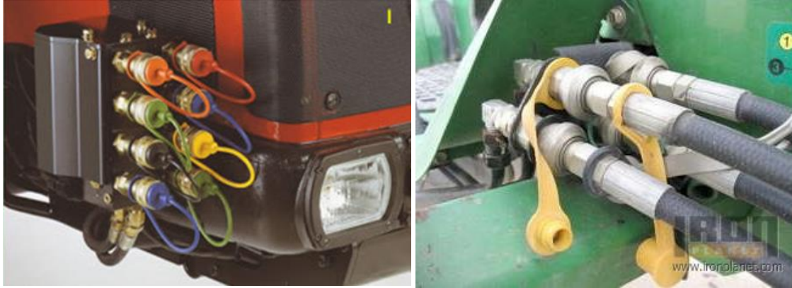
Figura 211: Salidas del circuito hidráulico protegidas por capuchones (Izquierda) Mangueras conectadas a las salidas (Derecha)
