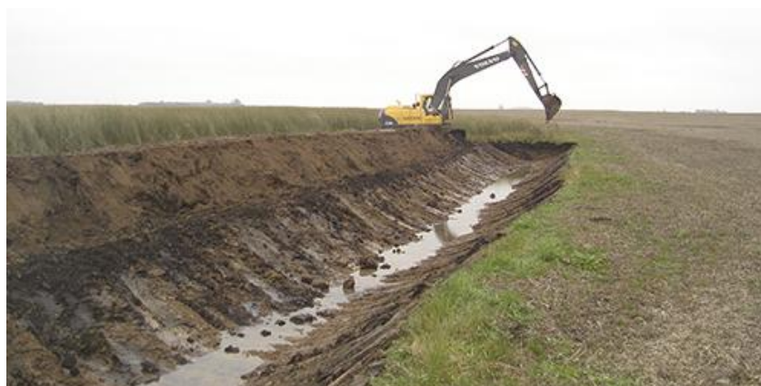
Figura 19. Construcción de badenes y bordos para conducir agua dentro del establecimiento hacia cubetas de almacenaje (Extraído de Damiano, 2000)
