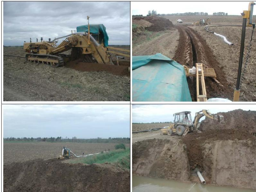
Figura 22. Instalación de drenes artificiales en campos azucareros de Jujuy. (Gentileza Ing. Agr. Fada).
