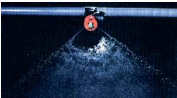
FIGURA V. 6 Observación de un chorro de abanico plano de funcionamiento normal.
